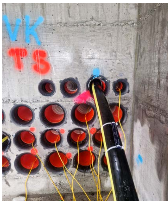
Das Innenleben eines Kabelschachtes.
