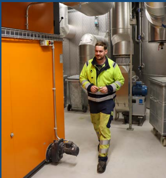
Rundgang in der Zentrale des Wärmeverbundes.
