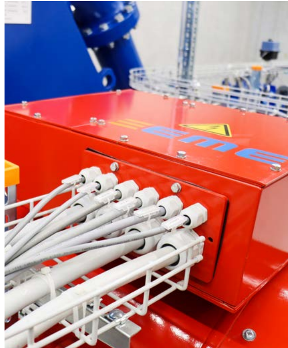
Anschlüsse des Generators.
