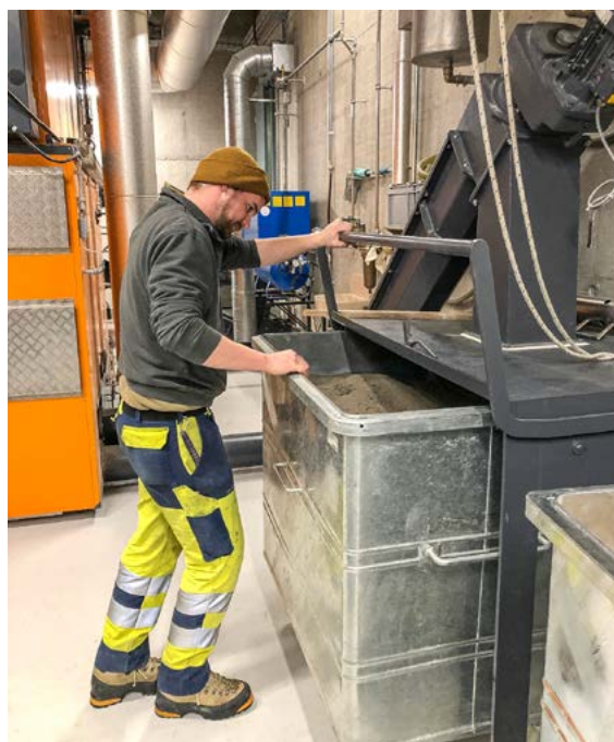
Kevin Gaus beim Kontrollgang im Wärmeverbund Linthal.
