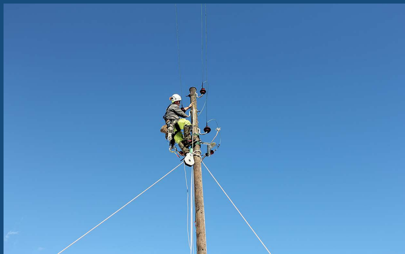
Christian Biasio auf dem betroffenen Freileitungsmast.
