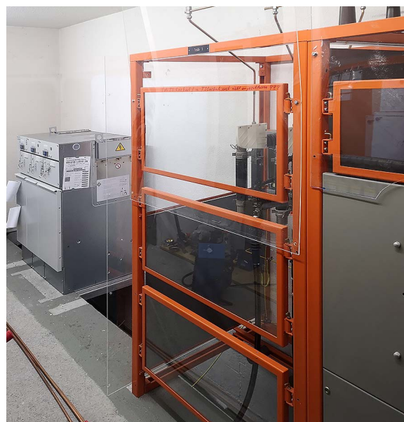
TS Chappelen während des Umbaus: links: neue Kompaktschaltanlage, rechts: alte offene MS-Anlage.
